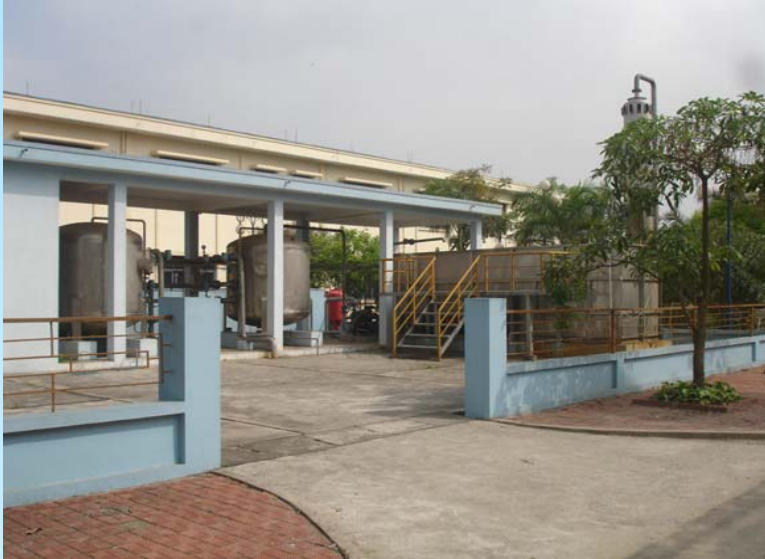
Station de l'eau sous terrain 1000m 3 /jour.
